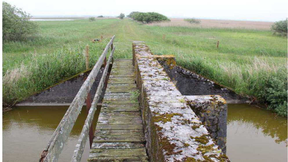
Figur 8: Udløbet fra Selbjerg Vejle gennem bygværket i Krapdiget (set mod øst).
